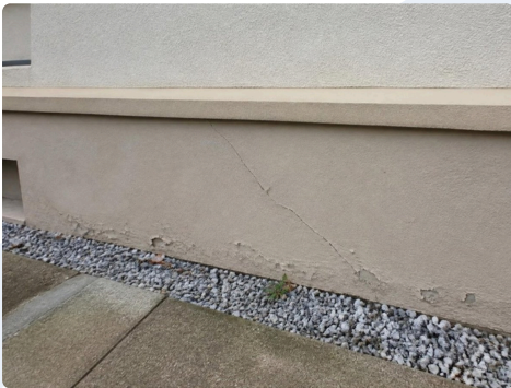
Bild 5 – Schräger Riss im Sockelputz.
