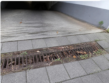
Bild 3 – Entwässerungsrinne an der Tiefgaragenzufahrt, mit Laub belegt.
